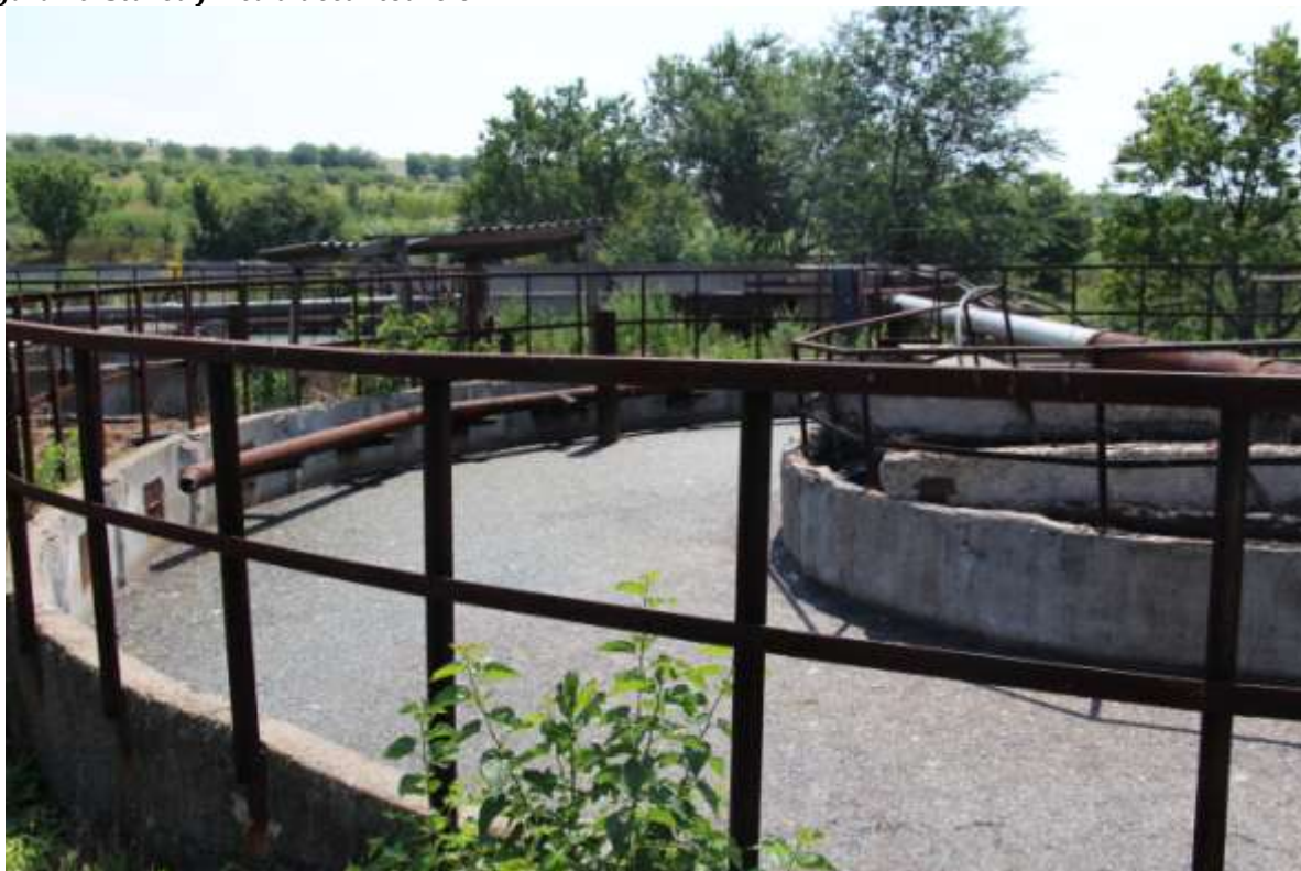
Figura 10. Starea fizică a decantoarelor
