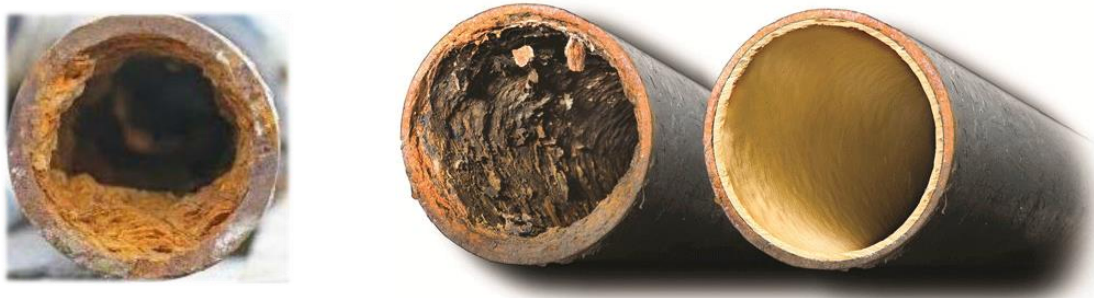
Fig. 7 Interiorul unui tub incrustat și după reabilitare
