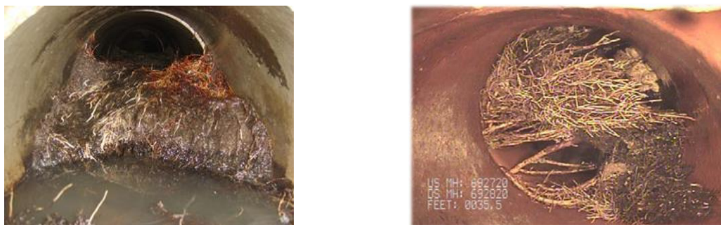
Fig. 21 Dezvoltarea de rădăcini în conducte și canale
