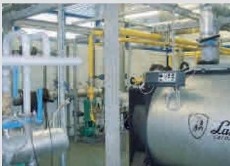
Вид внутри газовой котельной мощностью 4,5 МВт
