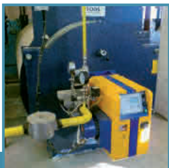
Горелочное устройство ГТВБ200 на котлах LOOS в котельной МК Щербинка, пос. Миллицейский, Московская область
