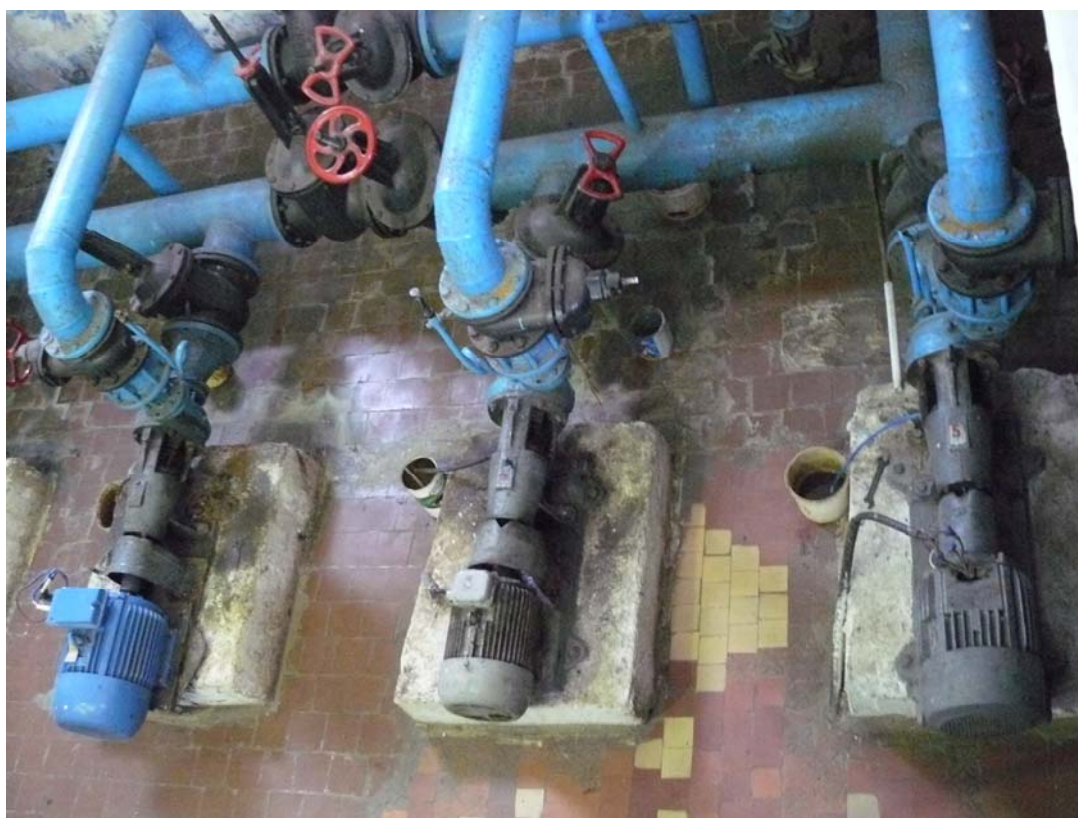
Poza nr.7 Stația de pompare a apei nivelul doi SP-2.
