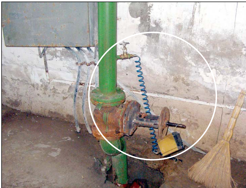
Foto 2.1. Măsurarea presiunii de apă în conducta de refulare SPRP.
