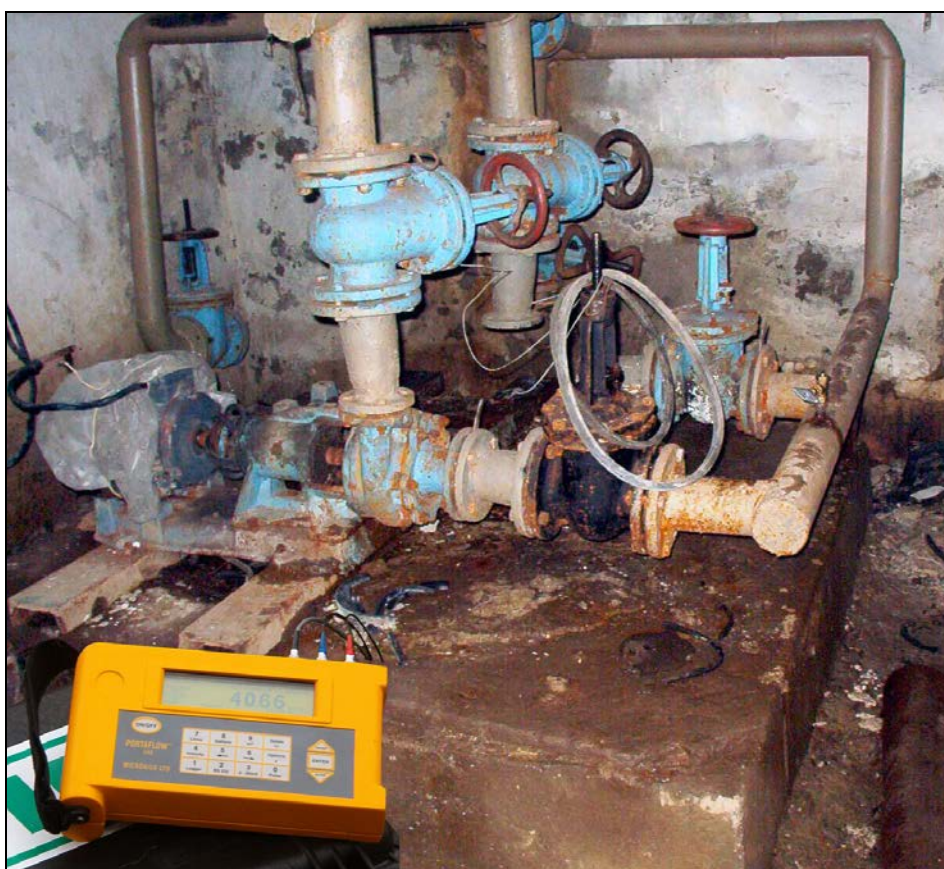
Foto 2.2. Măsurarea debitului de apă pe țeava de refulare la SPRP.
