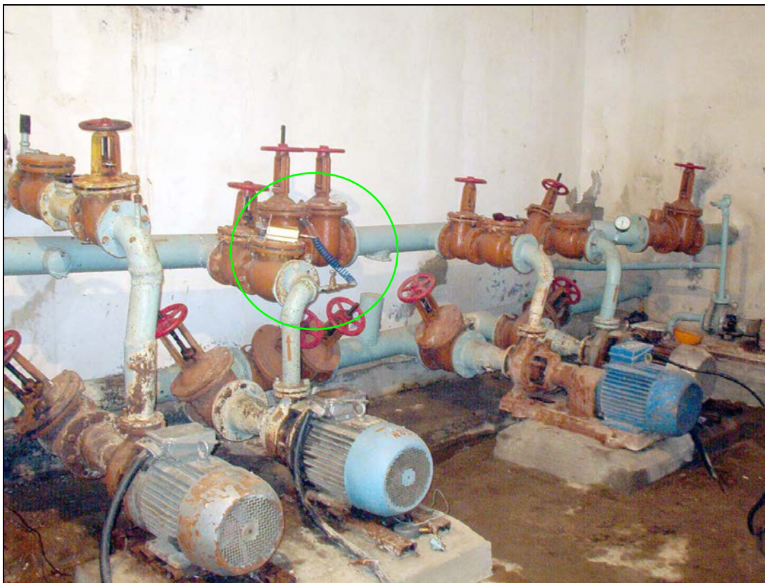
Foto 2.1. Măsurarea presiunii de apă în conducta de refulare a SP-III
