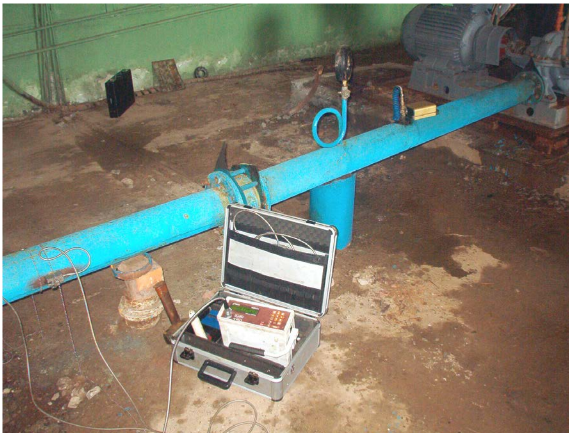
Фото 1.3.3. Замеры расхода воды и давления в трубопроводе на насосной станции.
