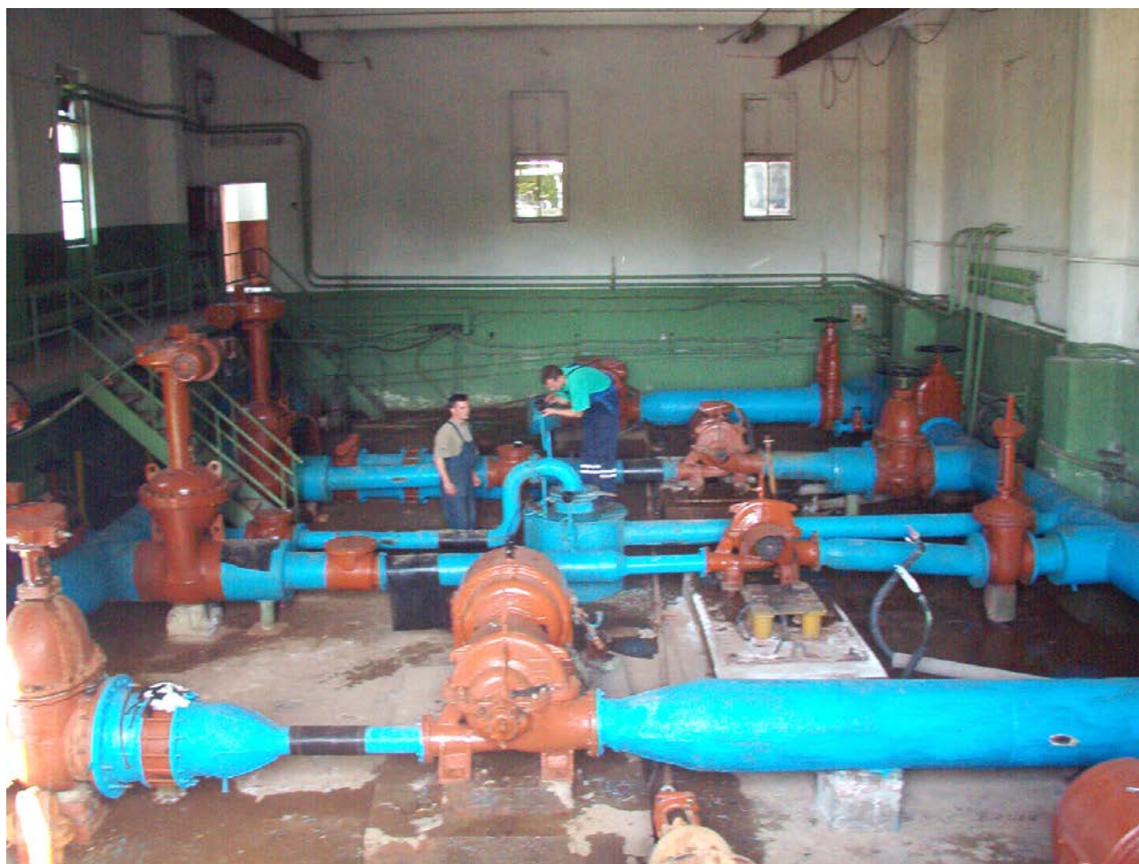
Фото 1.2.1. м. Бэлць. НС «Чарупина». Машинный зал.
