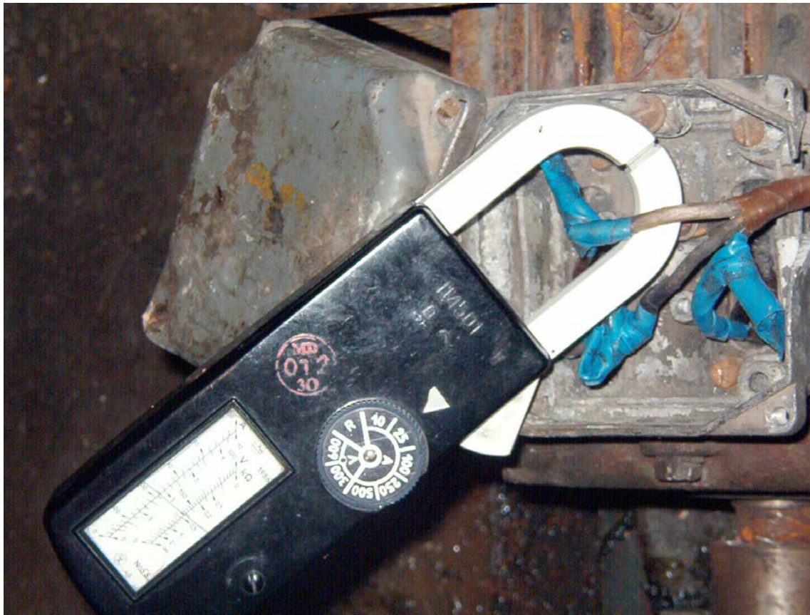
Фото 1.3.4. Замеры напряжения и силы тока у двигателя насосного агрегата.
