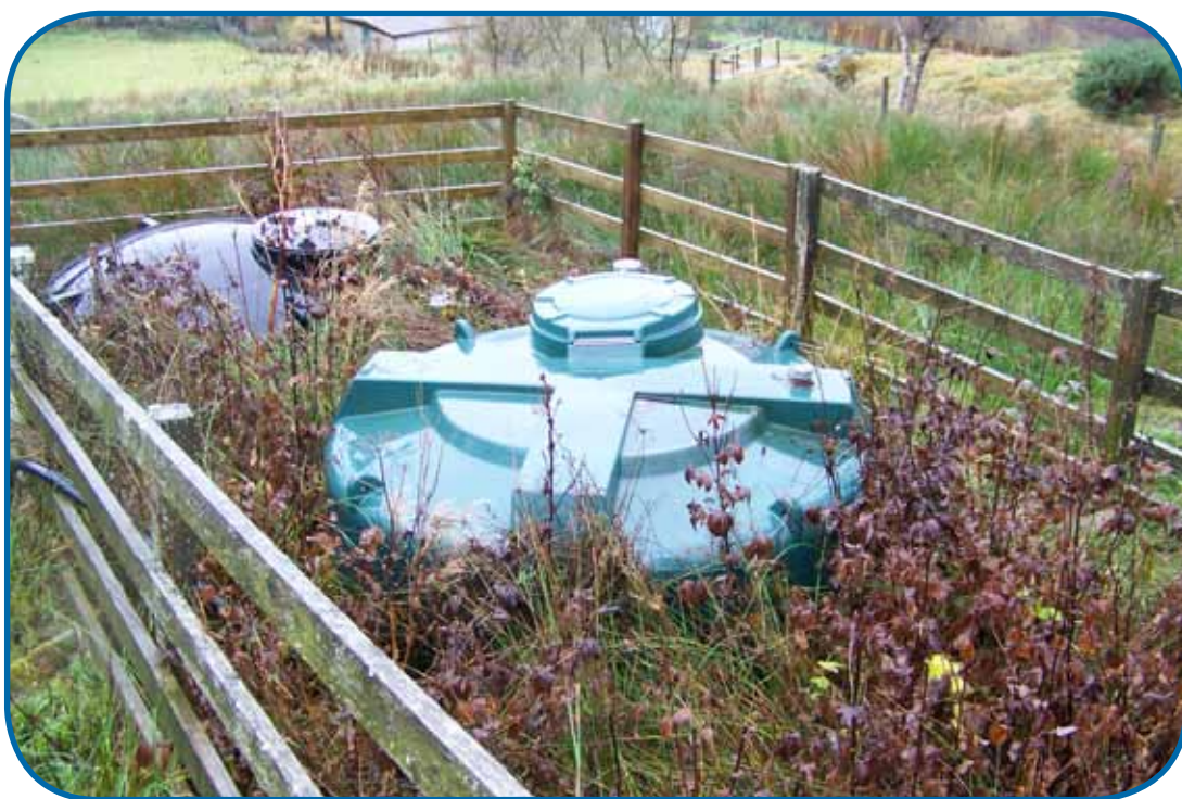
Частная система водоснабжения, Перт и Кинросс, Шотландия
