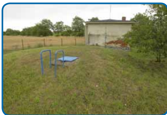
Поддерживаемое в надлежащем состоянии устье водяной скважины, снабжающей водой маленькую деревню в Южной Моравии, Чешская Республика ©Национальный институт общественного здравоохранения, Прага (Чешская Республика)/ Frantisek Kozisek
