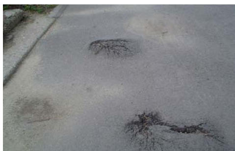
Fig. 5.43. - Expandarea asfaltului străzii ca urmare a umflării pământului de lângă conductă
