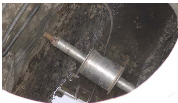
Fig. 5.35. - Tub de canalizare corodat
