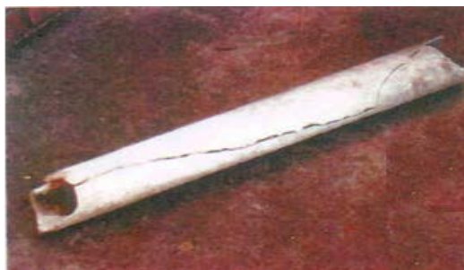
Fig. 5.18. - Fisurarea longitudinală sau circumferențială
