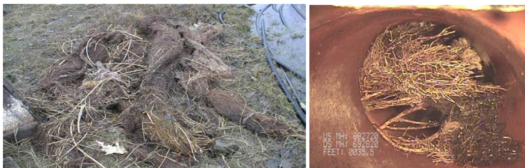
Fig. 5.25. - Dezvoltarea de rădăcini în conducte și canale
