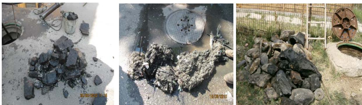
Fig. 5.28. - Materiale ce blochează rețeaua de canalizare
