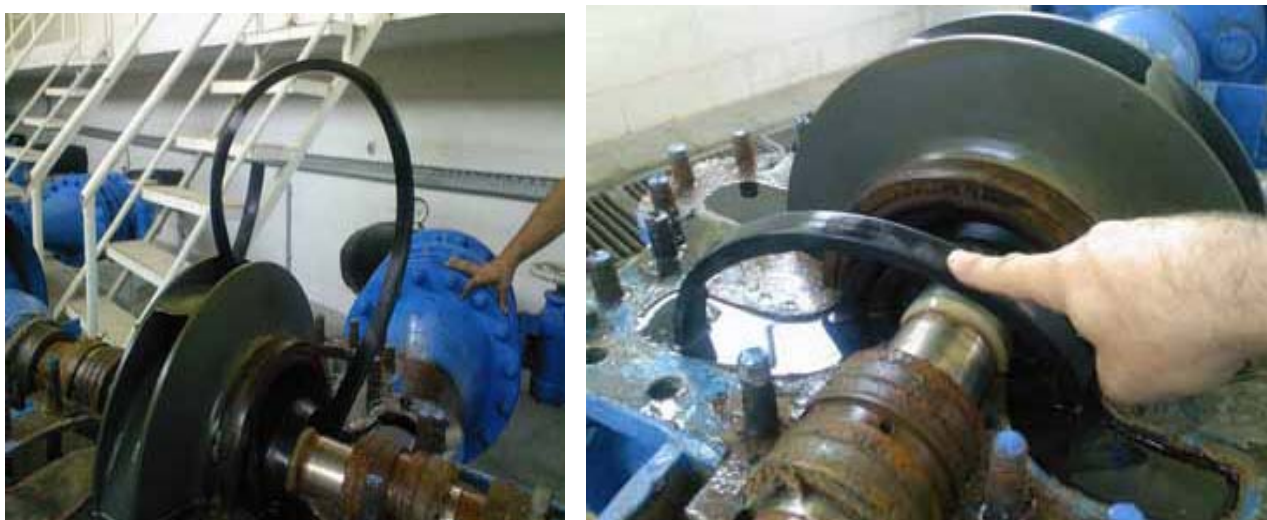
Фигура 10.53 Гумен ремък, причинил спадане на капацитета на помпена станция Boğaçay
