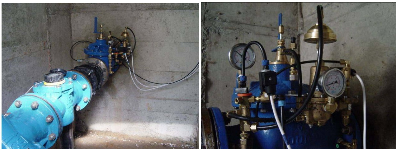
Фигура 10.23 PRV вентил с няколко настройки в DMA зона 123
