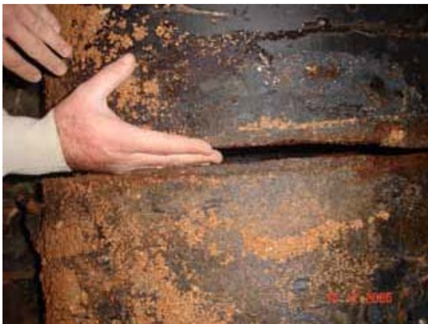
Фигура 3.9 Дефектирала тръба
