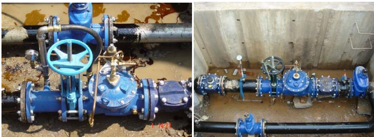
Фигура 10.25 Снимки с инсталация на PRV вентил в шахта с хидравлично модулиране
