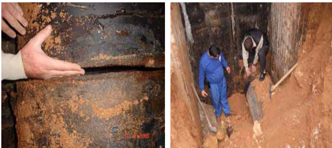
Фигура 10.52 Пукнатина на входната тръба на разпределителен резервоар Çağlayan
