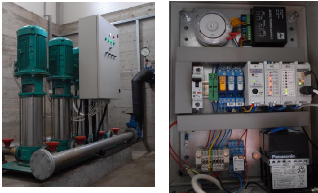
Fig.1. Pompa cu tablou de comanda
