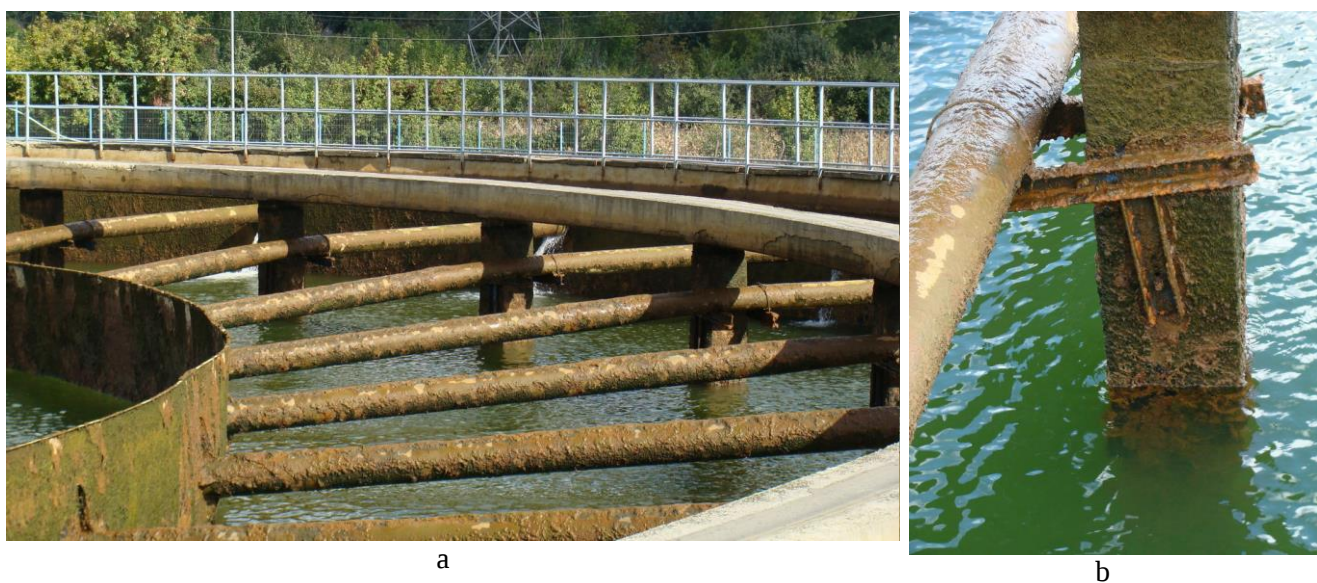
Fig. 4. Starea actuală a sistemului de suspendare a conductelor de captare a apei: a – vedere generală a conductelor de preluare a apei și peretelui despărțitor; b – detaliu privind modul de ancorare a conductei.
