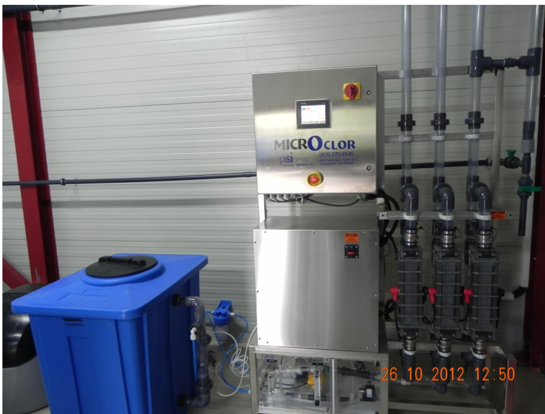
Figura nr. 7 – Generator de hipoclorit
