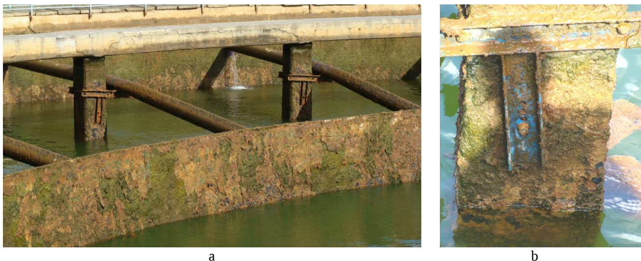
Fig. 5. Modul de deformare a conductelor de captare a apei: a – vedere generală a instalației de conducte rigidizată cu peretele despărțitor; b – detaliu privind modul de deformare a consolei.
