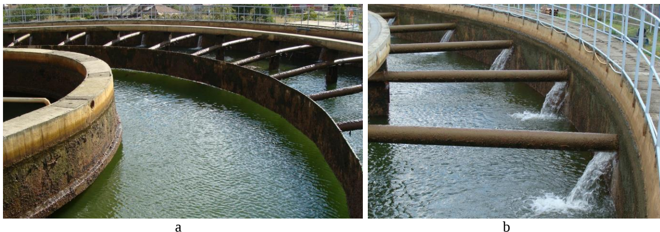
Fig. 2. Starea actuală a instalației hidraulice de colectare a apei tratate: a – vedere generală a instalației hidraulice; b – racordul conductelor la jgheabul de colectare.
