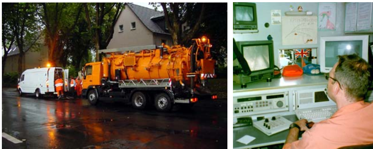
Bild 54: Betrachtung der Strahleigenschaften von HD-Düsen vor Ort im Kanalnetz
