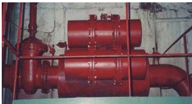
СД-16-350 на системе пожарно-технического водоснабжения, филиал «Костромская ГРЭС» ОАО «ОГК-3»
