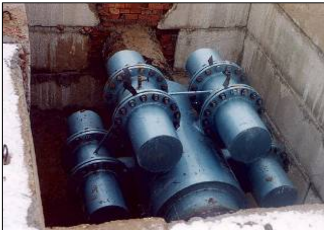
СД-16-600 на системе водоснабжения, Деснинский ВЗУ МУП «Водоканал» г. Подольск
