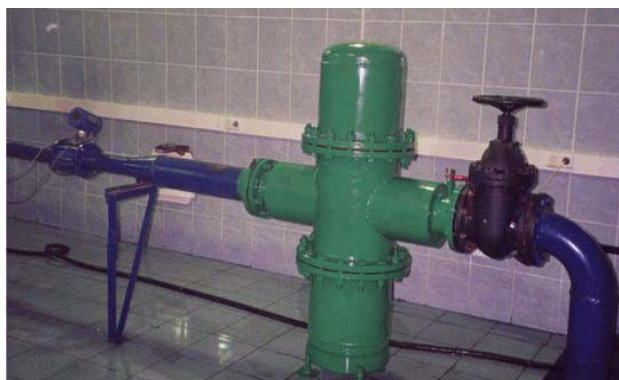
СД-16-150 на системе водоснабжения п. ВИР, филиал «Юго-Западный Водоканал» ГУП «Водоканал Санкт-Петербурга»
