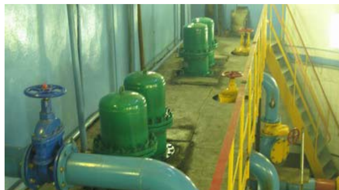
СДК-16-200 на системе водоотведения, КНС Крылатское МГУП «Мосводоканал»
