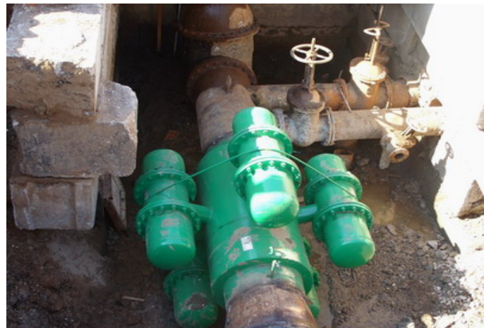
СД-16-500 на системе водоснабжения, ПНС-11 МП «Самараводоканал»
