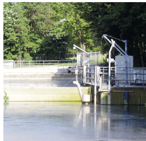
Epurarea apelor uzate comunale Municipal sewage purification Kommunale Abwasserreinigung
