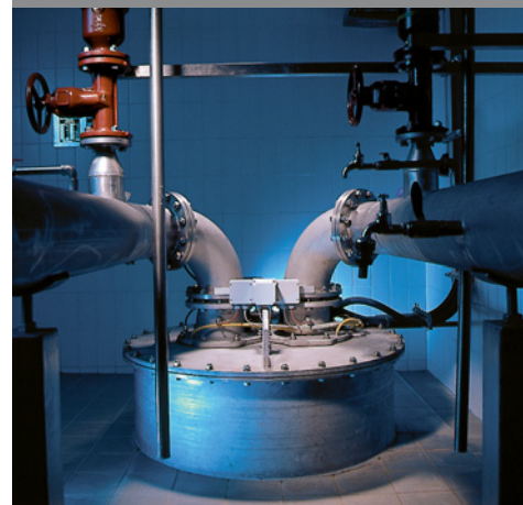
Cap de puț vertical într-o stație de pompare Well cover, vertical well at the pumping station Brunnenkopf, Vertikalbrunnen im Pumpwerk
