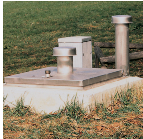
Cap de puț vertical în teren Well cover, vertical well at territory Brunnenkopf, Vertikalbrunnen im Gelände
