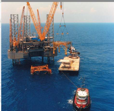
Pompe de balast Ballast pumps Ballastpumpen
