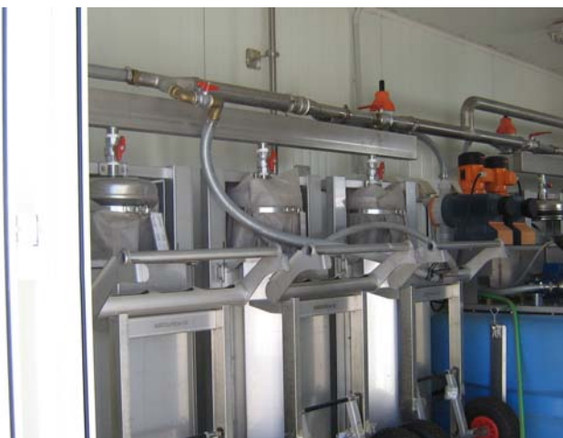
Fig.nr.4.6. Stație de epurare Resetilovs: unitate deshidratare
