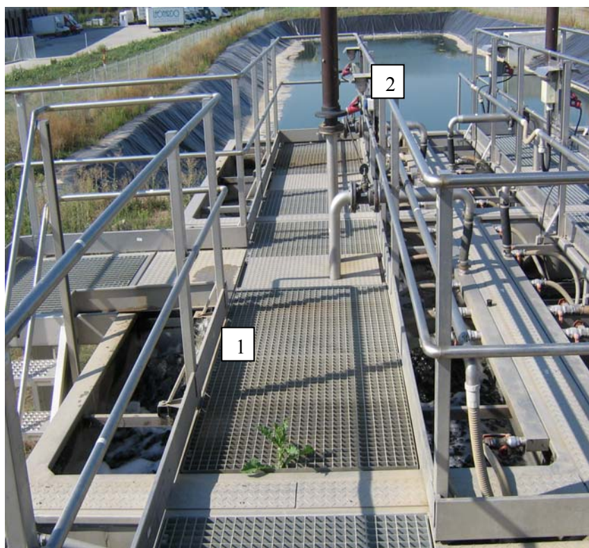
Fig.nr.4.4. Stație de epurare Resetilovs: 1. modul biologic 2. bazin retenție apă epurată
