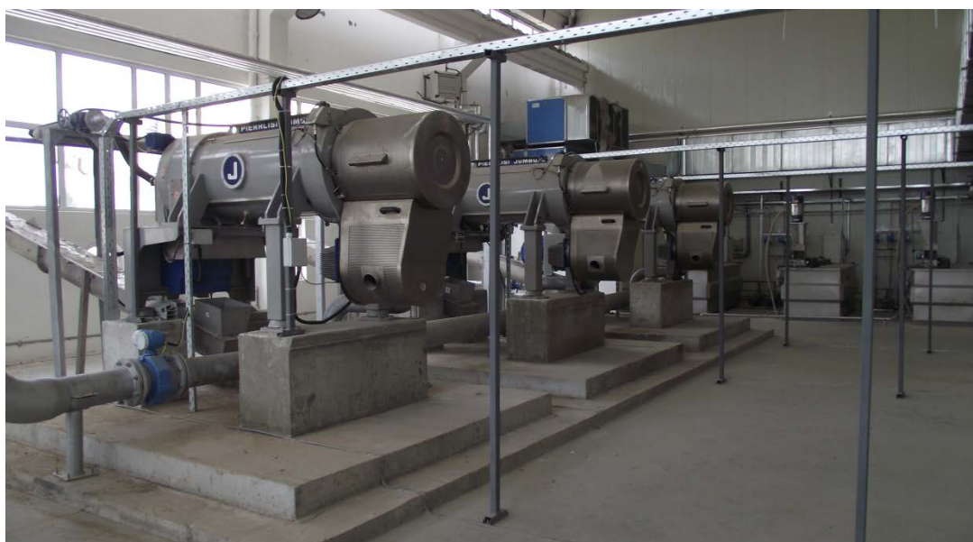
Figura 6.4 Instalații de deshidratare mecanică a nămolului
