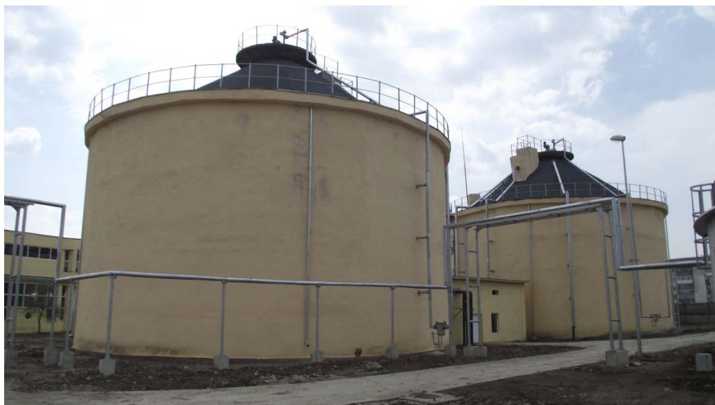
Figura 6.3 Rezervoare de fermentare a nămolului
