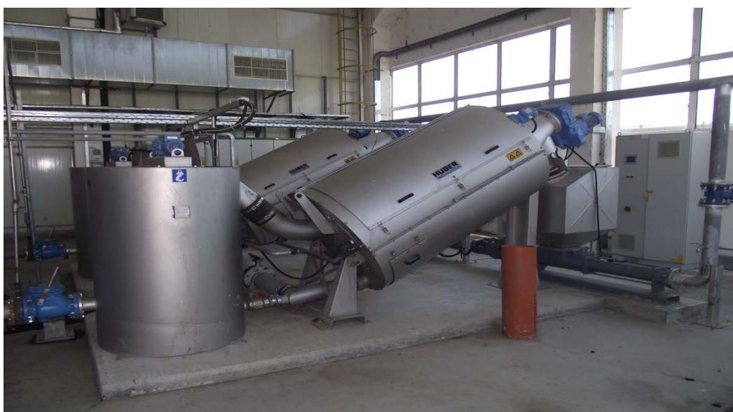
Figura 6.2 Îngroșătoare mecanice nămol în exces
