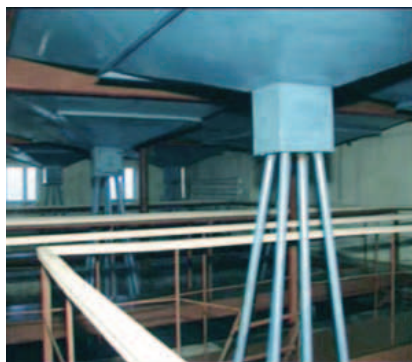
Рис. 7.4. Вид аэрационных колонн
